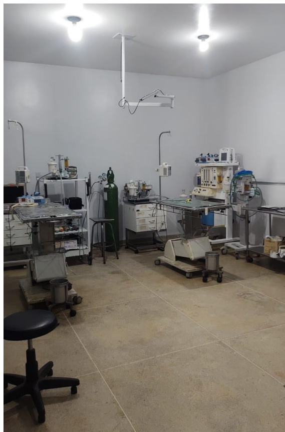
15 Figura 7: Sala de cirurgia do setor de CCPA, do 16 Hospital Universitário Veterinário/UFPB. 17 Fonte: Setor de Clínica Cirúrgica de Pequenos 18 Animais UFPB – Campus Areia (2025). 19
