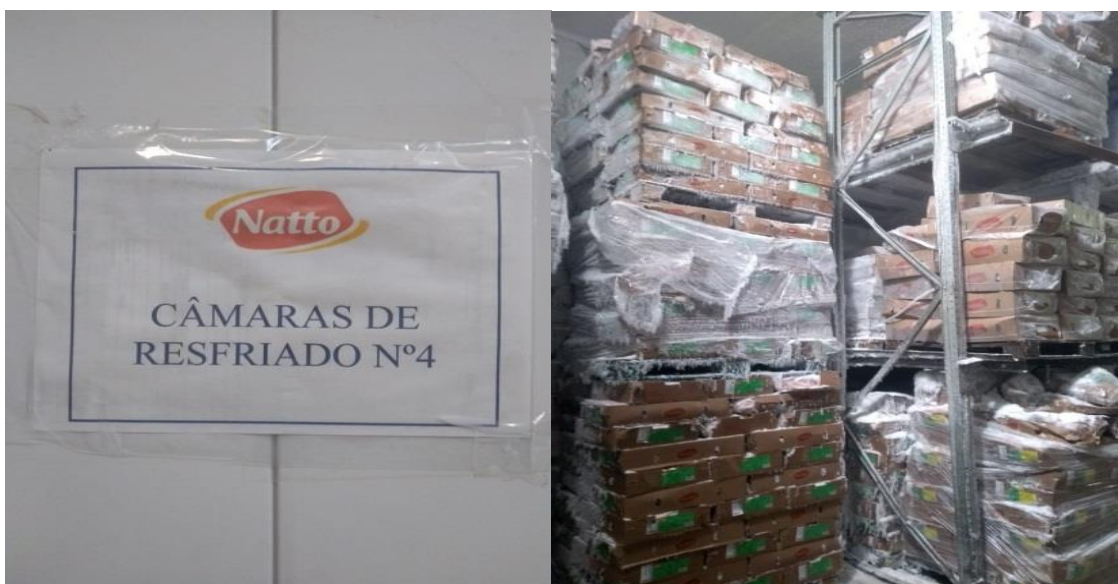
Figura 58- Câmara de armazenamento de resfriado Fonte: Arquivo Pessoal
