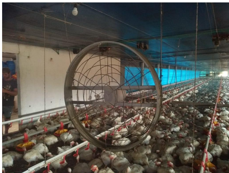
Figura 5 - Galpões de pressão positiva - Ventiladores.
