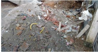
Figura 03 - Armazenamento inadequado de resíduos no empreendimento D
