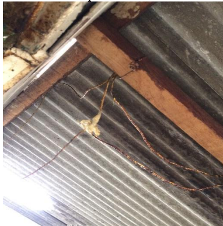
Figura 13: Fiação exposta e teto inadequado na cozinha.
