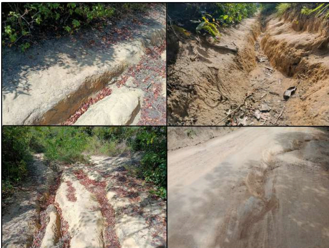
Figura 17 - Processos erosivos encontrados no parque.
