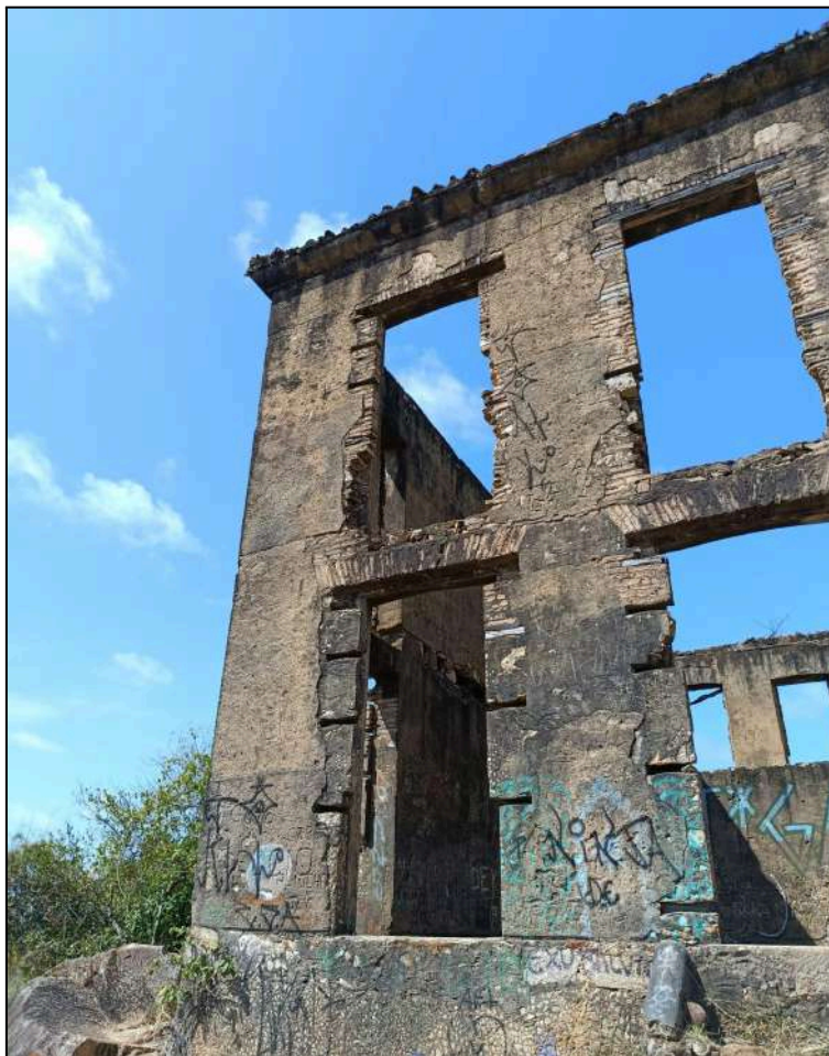
Figura 33 - Marcas de vandalismo nas ruínas da Casa do Faroleiro.
