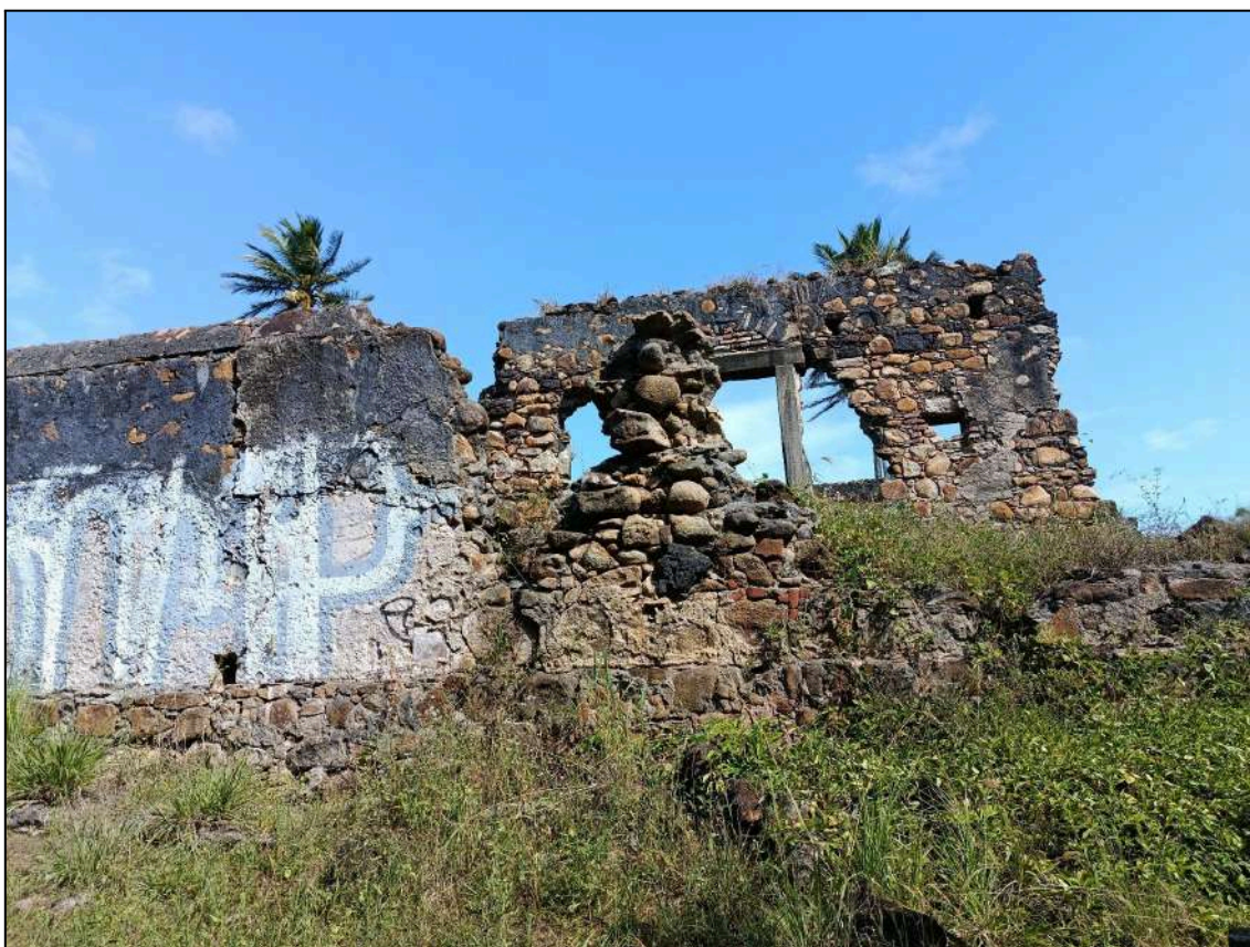
Figura 40 - Registro de situação de abandono patrimonial.
