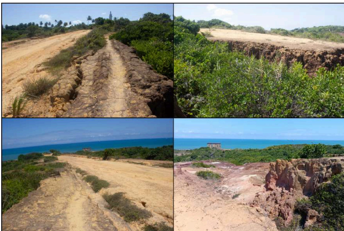
Figura 31 - Processos erosivos no entorno do Mirante Vila Velha.
