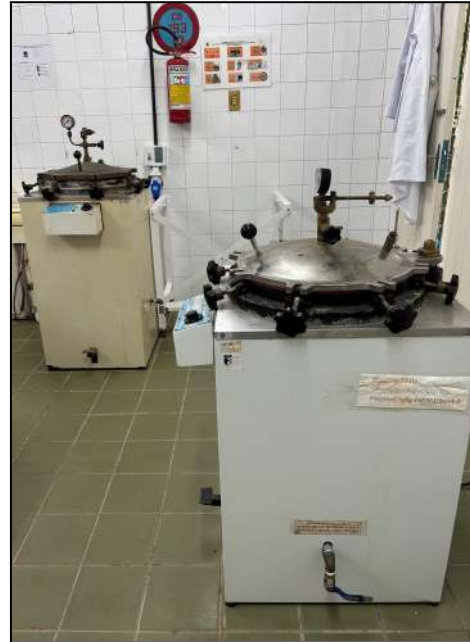
Figura 21. Equipamentos da sala de autoclave.
