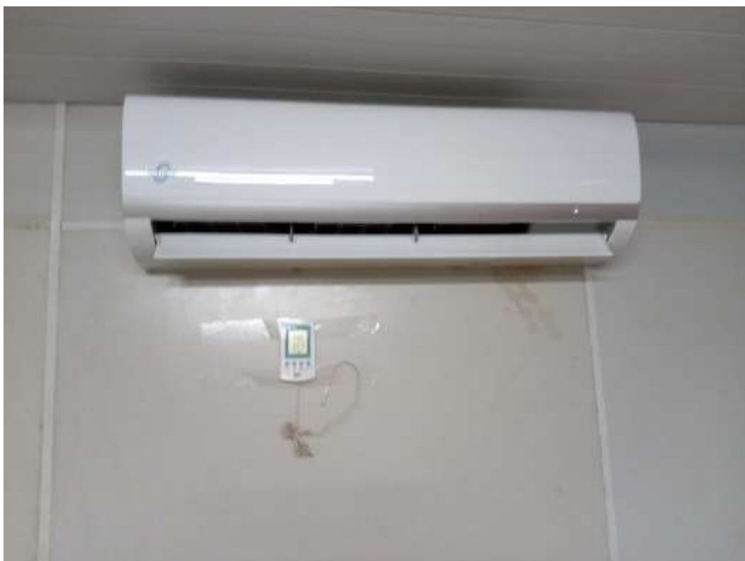
Figura 12 - Ar-condicionado da sala de sementes
