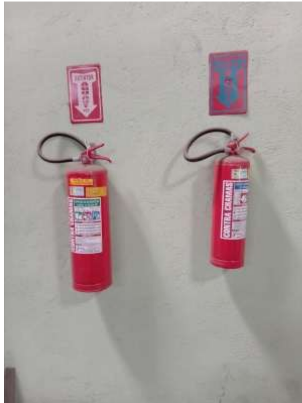
Figura 7 - Extintores espalhados pela loja e estoque
