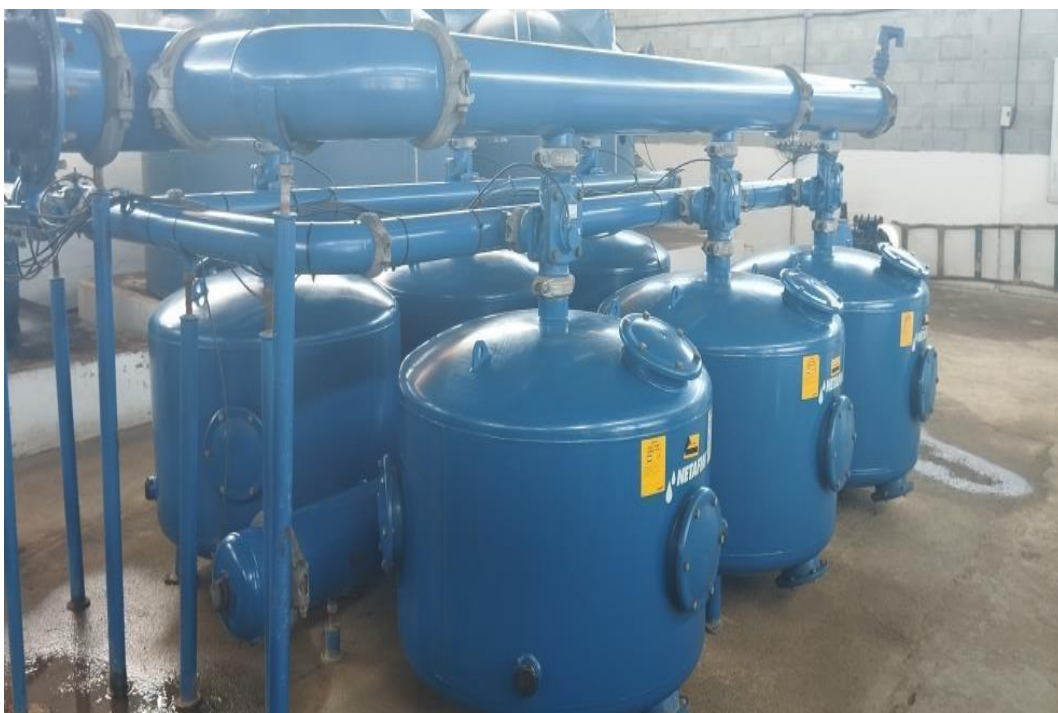
Figura 50-Um dos conjuntos de filtro de areia da netafim utilizados no projeto de gotejo
