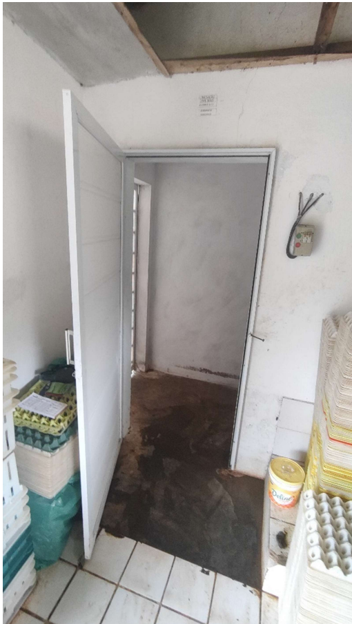
Figura 11 – Acesso para sala de fumigação a partir da sala do ovo embrionado. Fonte: Arquivo pessoal, 2024 (Autorizado pela empresa).
