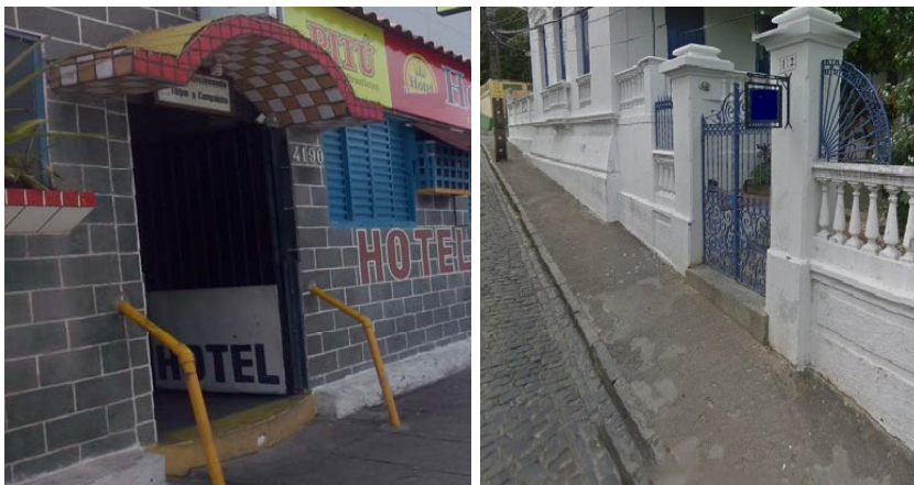
Figura 2 (esquerda) e Figura 3 (direita) – Inadequação das calçadas, obstáculo, ausência de rampa e piso tátil.
