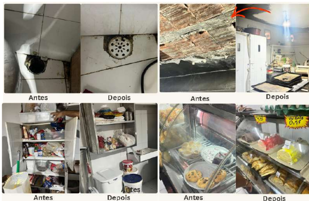
Figura 11. Reinspeção em padaria com correção das áreas críticas
