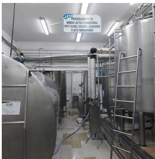
Figura 14 - Sala de processamento de bebida láctea fermentada, queijo petit suisse, iogurte, coalhada e leite fermentado.
