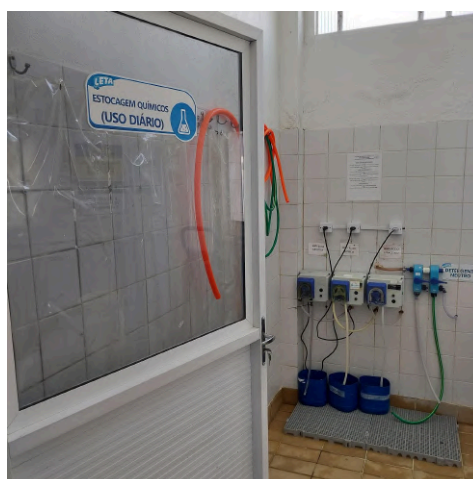
Figura 25- Sala de estoque de produtos químicos (uso diário)
