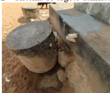
Figura 12 – Sistema de esgoto danificado
