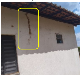
Figura 13 – Fissuras, visita in loco
