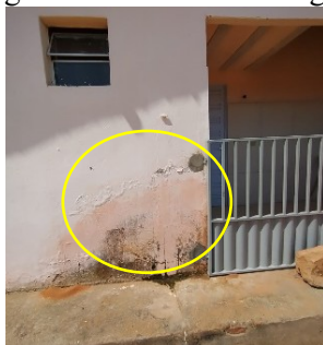
Figura 11 – Manchas de água
