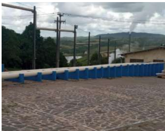
Figura 98. Tubulações de transporte de resíduos Fonte: Arquivo pessoal
