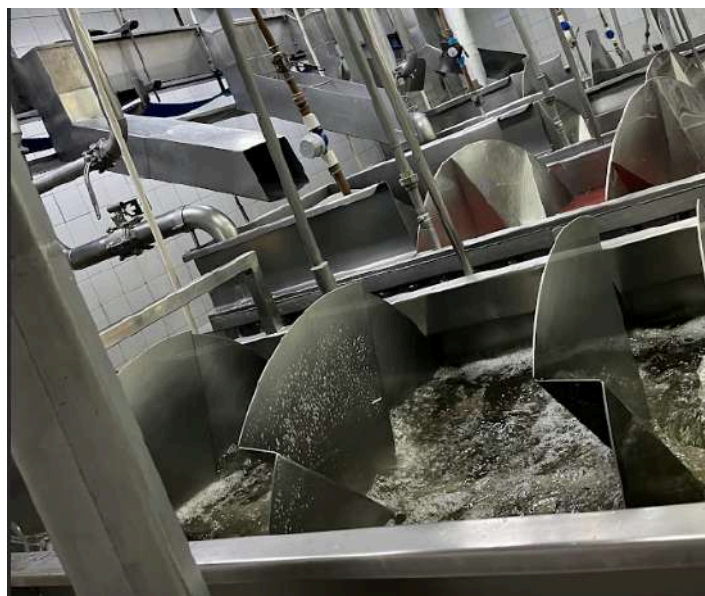
Figura 87. Mini-chiller de miúdos Fonte: Arquivo pessoal
