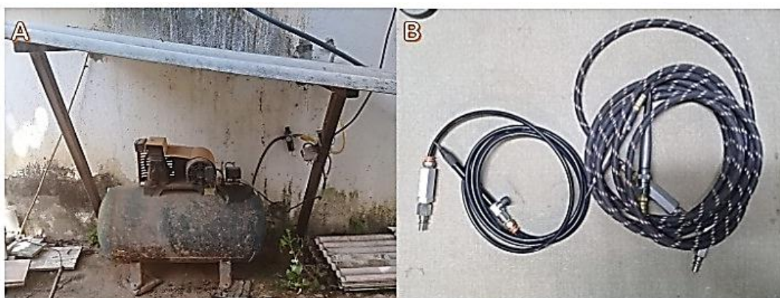
FIGURA 32: A) Compressor de ar localizado na área externa do LPU – URCA. B) Canetas pneumáticas de compressão. Fonte: João Silva, (2018).
